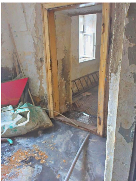
Obrázek 4: Průsak kanalizace do jednoho z neobývaných bytů v jednom z domů „u Urbana“
