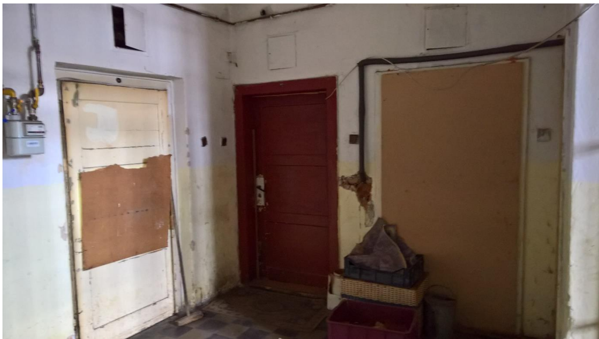
Obrázek 11 Opravený přívod vody, vstup do obývaného bytu (uprostřed), zatlučené vchody do neobývaných bytů, Mánesova č. p. 2
