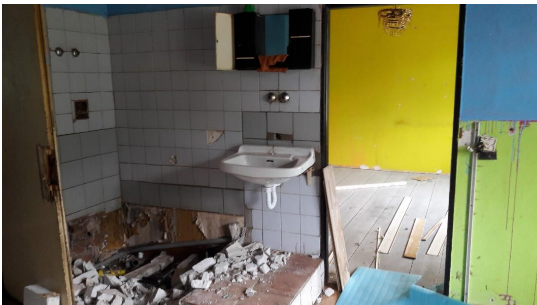
Fotografie č. 6: Opuštěný byt
