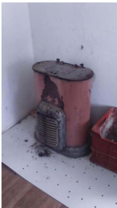
Fotografie č. 14: Trpoměchy – krbová kamna sloužící k vytápění celého bytu
