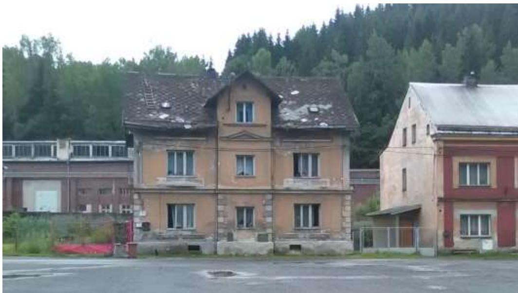
Fotografie č. 2: Sociálně vyloučený rodinný dům na Kraslické, stav k červenci 2017
