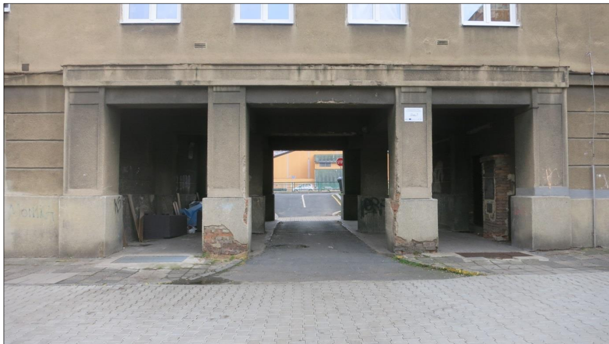
Fotografie č. 3: Průchod v propojce 99/100 (neopravená fasáda i dlažba, skládka)
